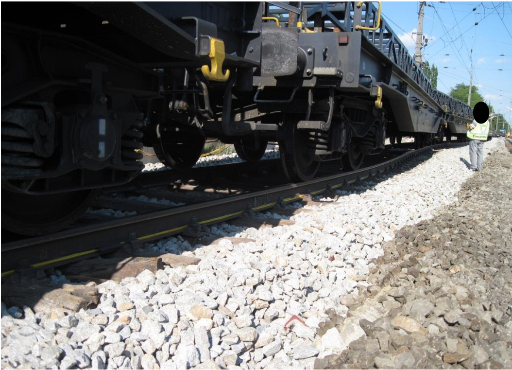
Abbildung 15 Gleisverdrückung im Bereich der Holzschwellen Weiche 203 (Quelle IM)
