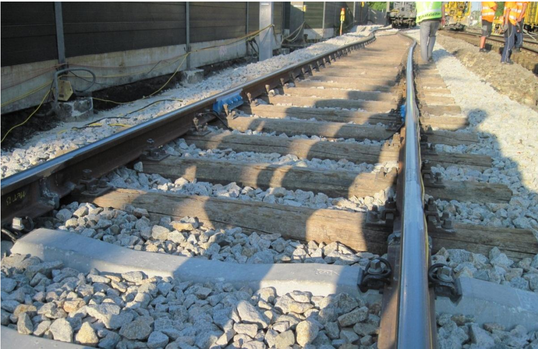
Abbildung 13 Gleisverdrückung am Übergang Betonschwellen/Holzschwellen im Bereich der Weiche 203 (Quelle IM)
