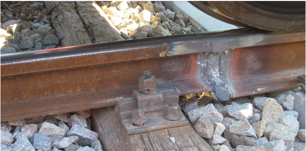
Abbildung 29 Aluminothermische Schweißstelle am Übergang von Schienenprofil 54E2 - Holzschwellen auf 60E1 - Betonschwellen (Quelle IM)
