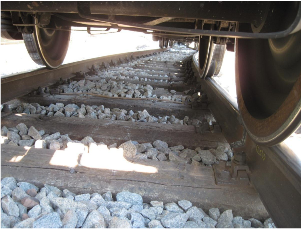
Abbildung 17 Gleisverdrückung im Bereich der Holzschwellen Weiche 203 (Quelle IM)
