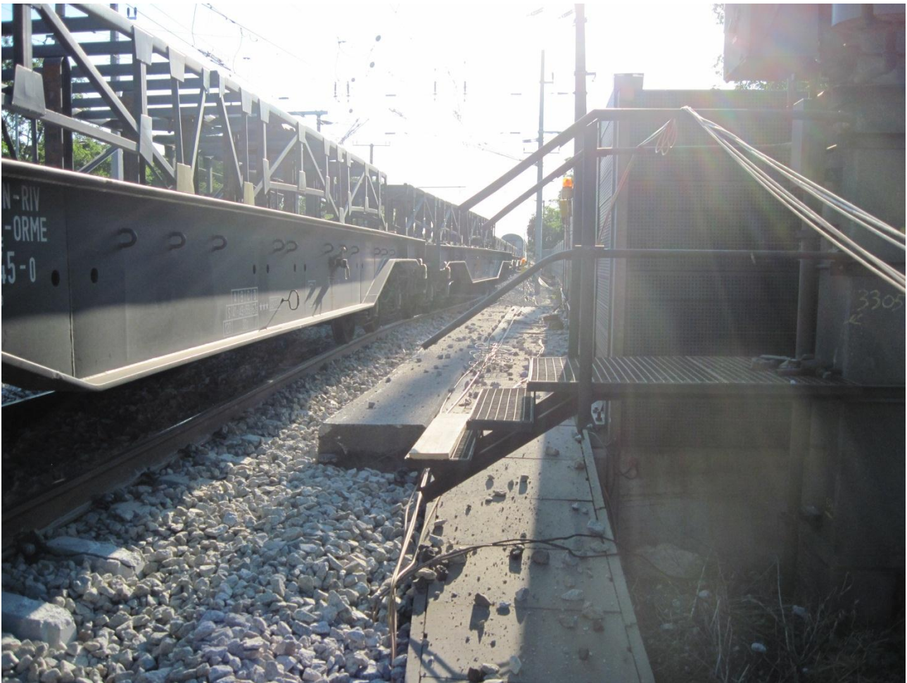
Abbildung 31 Lärmschutzwand neben Gleis 1 (Quelle IM)
