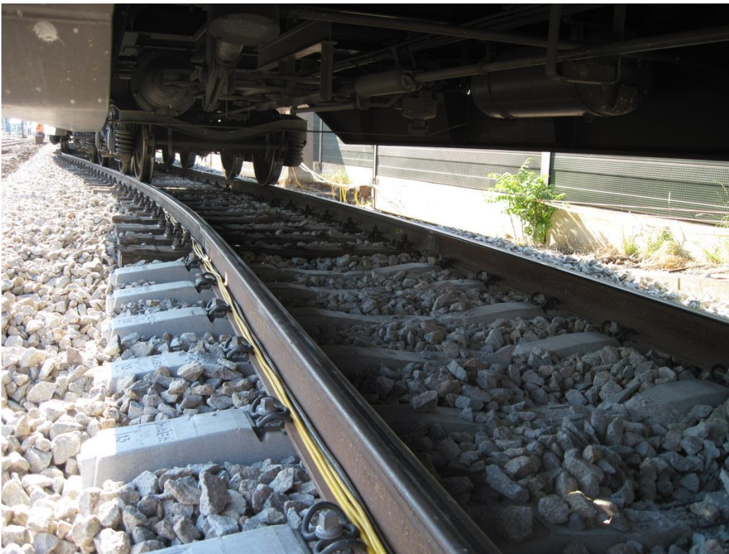
Abbildung 16 Gleisverdrückung im Bereich der Holzschwellen Weiche 203 (Quelle IM)
