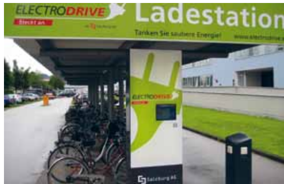
Öffentliche E-Radladestation in Salzburg, Foto: Österreichische Energieagentur
