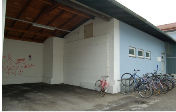
Abbildung 233: Beispiel für eine mangelhafte Überdachung einer Fahrradabstellanlage, großzügiger Unterstand links davon ist für Kfz reserviert
