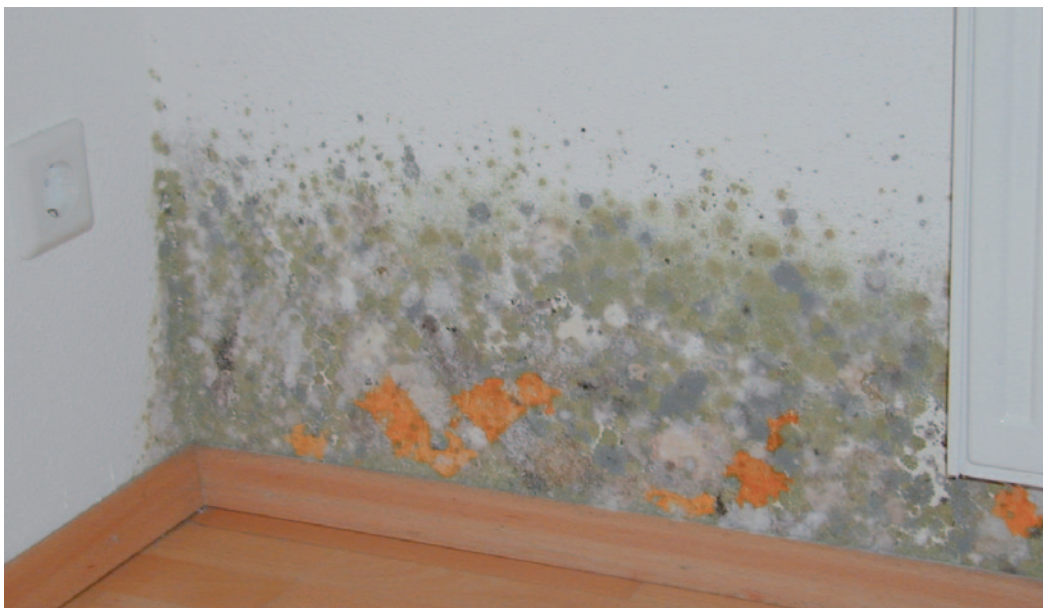
Massiver Schimmelbefall an Außenwand
