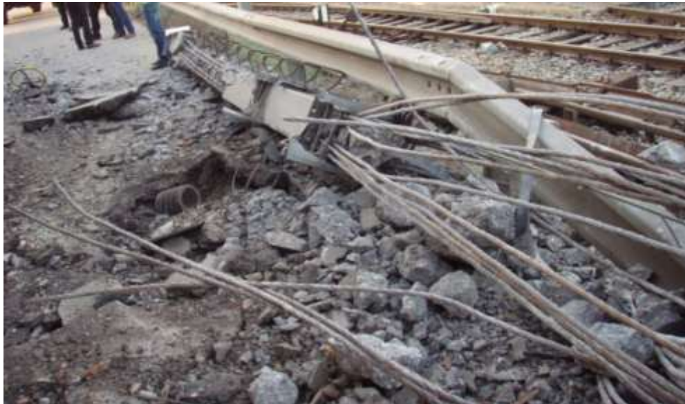
Abbildung 9 Beschädigte Begleitstraße und zerstörter Mast der Oberleitung
