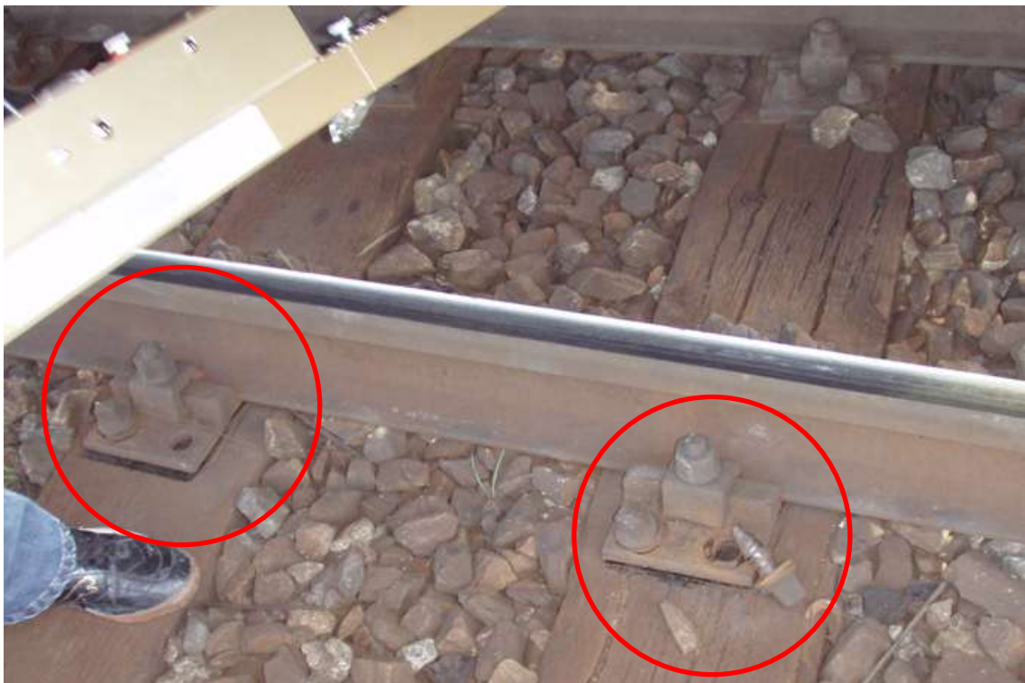
Abbildung 34 Mangelnder Kraftschluss - Fehlende und lose Schwellenschrauben
