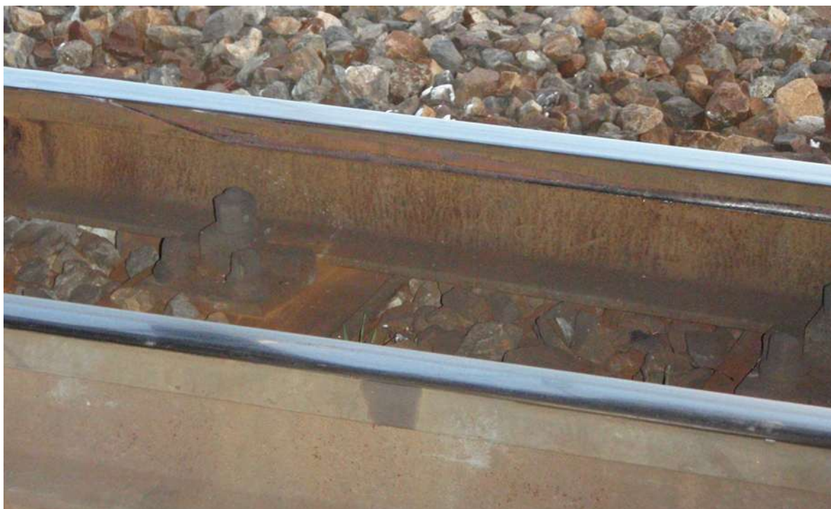
Abbildung 12 Erste Entgleisungsspuren zwischen Herzstück und Spitze der Weiche 283 - Quelle IM
