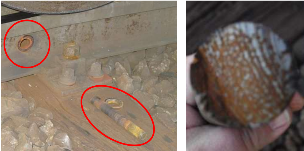
Abbildung 37 Gebrochenen Weichenschraube beim Herz der Weiche 283 - Quelle IM
