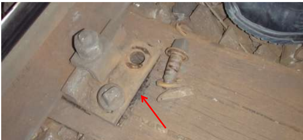
Abbildung 36 Mangelnder Kraftschluss mit fehlender und loser Schwellenschraube
