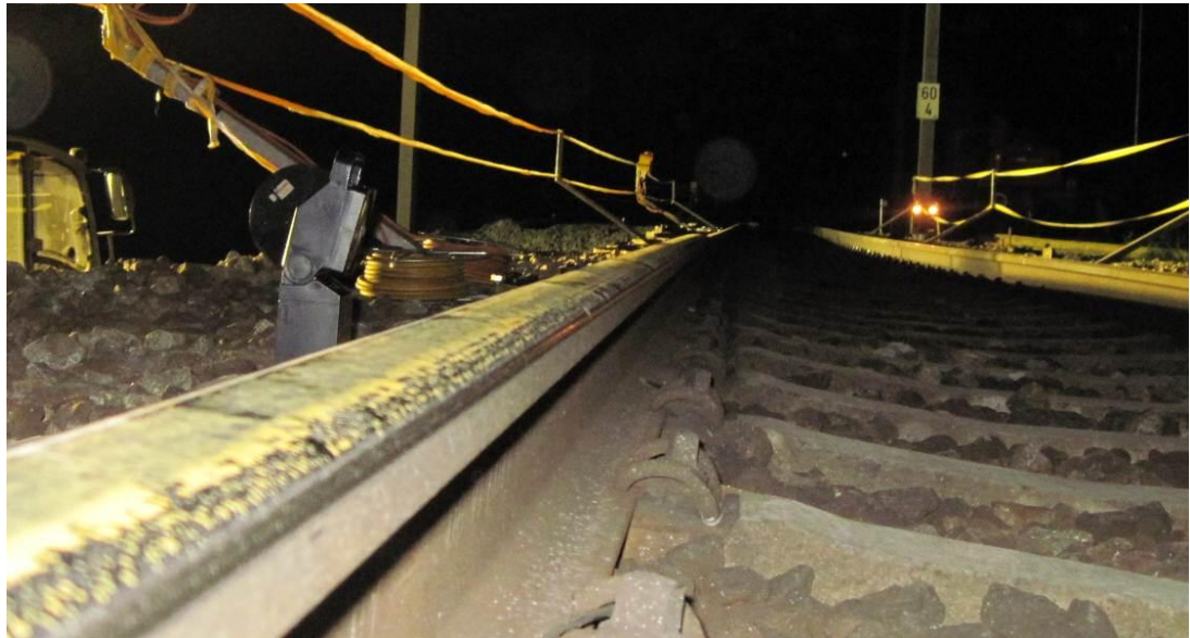
Abbildung 14 Ansicht der Stelle der Gleisverwindung km 60,335 gegen Fahrtrichtung – Quelle IM
