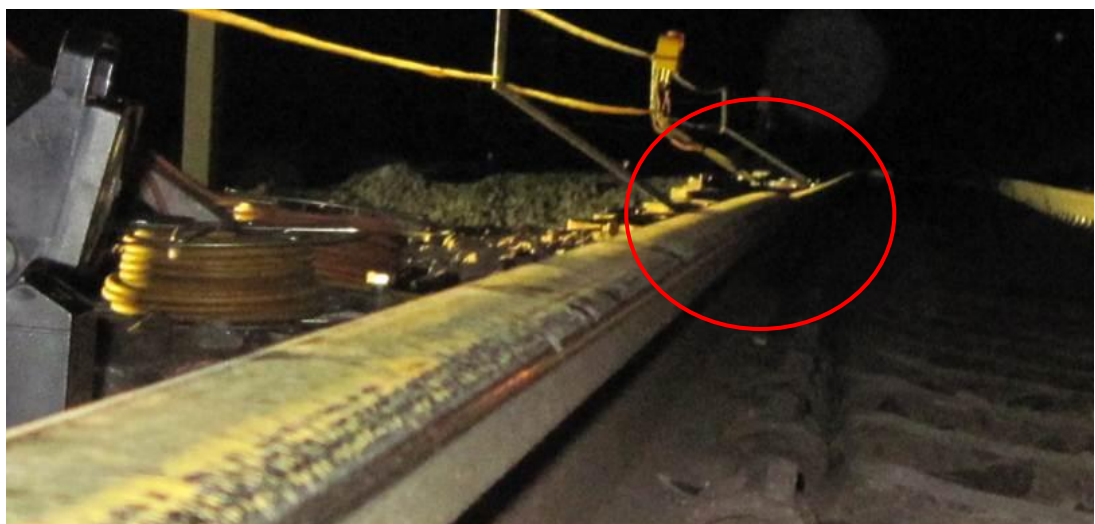
Abbildung 15 Ansicht der Stelle der Gleisverwindung km 60,335 gegen Fahrtrichtung – Detail – Quelle IM
