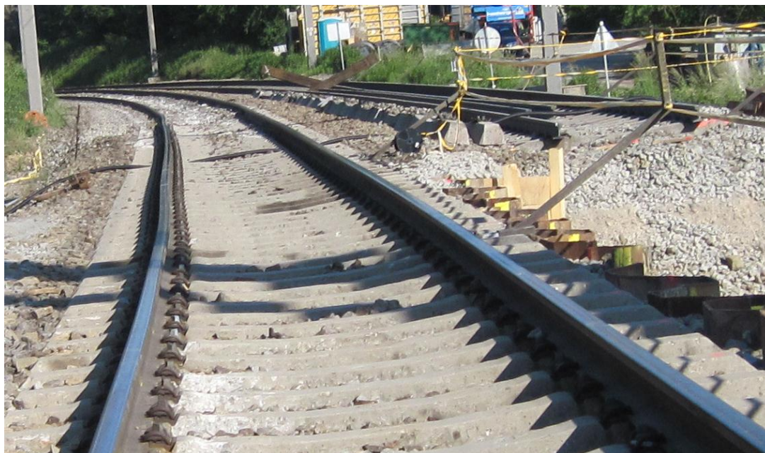
Abbildung 16 Entgleisungsstelle in Fahrtrichtung Z 44937 am Folgetag – Quelle IM
