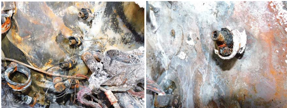
Abb. 5 Schlauchschellen auf den motorraumseitigen Rohrenden der zwischen den elektrischen Kraftstoffpumpen und den Vergasern in der Kabine verlegten Metallrohrleitungen (Quelle: SUB).
